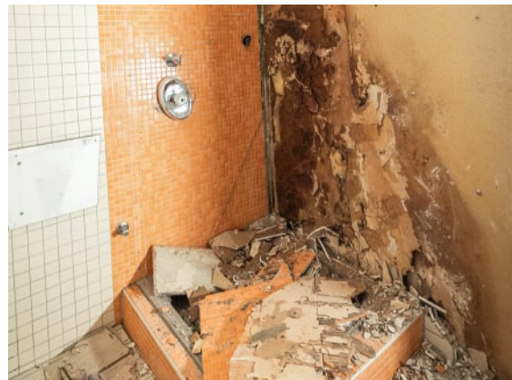
2024: Durchnässte Wand ohne Verbundabdichtung
