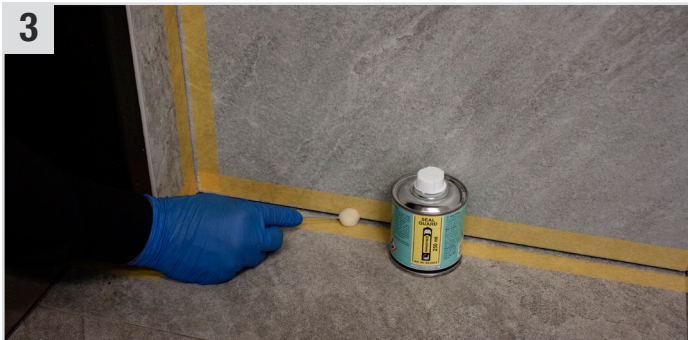
3 Die entsprechenden Stellen mit SunCore Pro (Abdeckband) abkleben und eine dünne Schicht Seal Guard (Transparenter Primer) mit Wollwischer Luxury anbringen. (15 Min. ablüften lassen)
