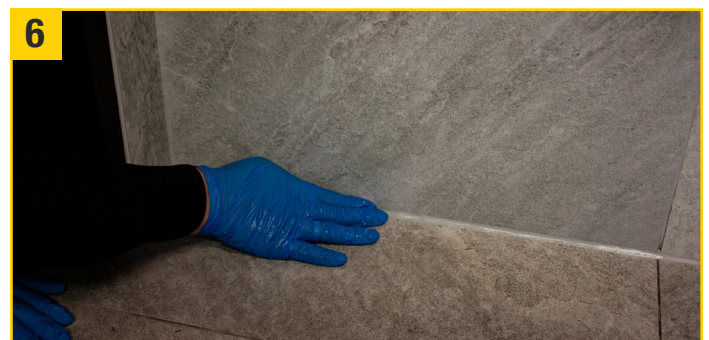
6 Abschließend SunCore Pro (Abdeckband) entfernen und mit Seal Fluid (Lösungsmittelfreies Glättmittel) vorsichtig abglätten. Fertig!
