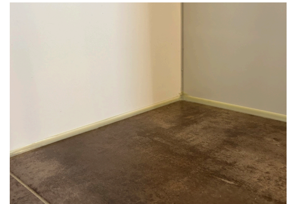
2024: Nach 13 Jahren keine Anzeichen von Schimmel oder Rissbildung (trotz Fußbodenheizung)
