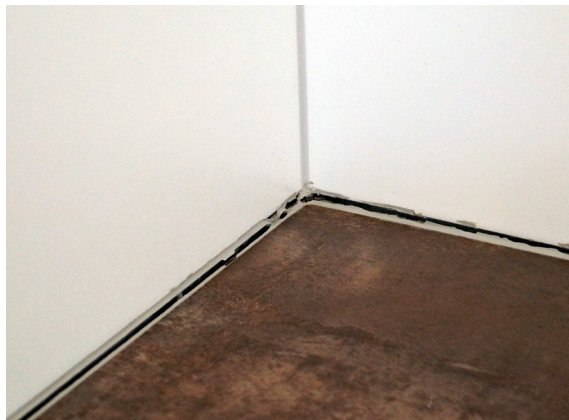
2011: Gerissene Fugen nach nur ca. 3 Monaten Benutzung
