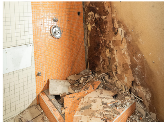
2024: Durchnässte Wand ohne Verbundabdichtung
